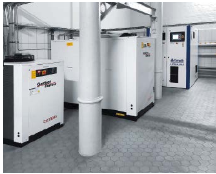
■ Abb. 3: Die neue Kompressorstation senkt deren Energiekosten um bis zu 25 % gegenüber den Vorgängermaschinen.
