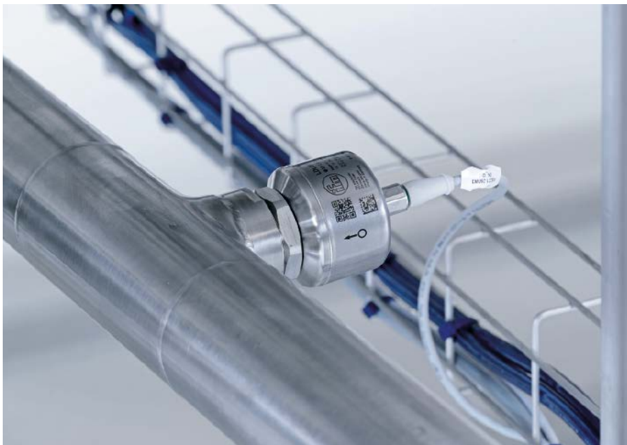
■ Abb. 3: Der Leitfähigkeitssensor LDL200 erkennt zuverlässig, ob sich klares Wasser oder Reinigungsflüssigkeit vom CIP-Prozess in den Rohren befindet. Gleichzeitig misst er auch die Temperatur und überträgt beide Messwerte per IO-Link an die Anlagensteuerung.
