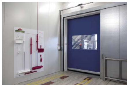
■ Abb. 2: Vor allem die Produktionsräume sowie die Abfüll- und Abpackanlagen sind mit den Reinraumtoren EFA-SRT EC hermetisch abgeschlossen.
