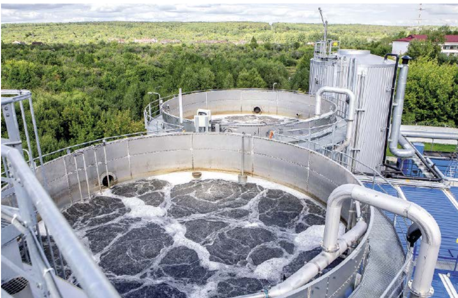
Abb.: Experten von Envirochemie nehmen von Anfang an die gesamte Prozesskette in den Blick: von der Planung über den Anlagenbau bis hin zu Betrieb und Service.
