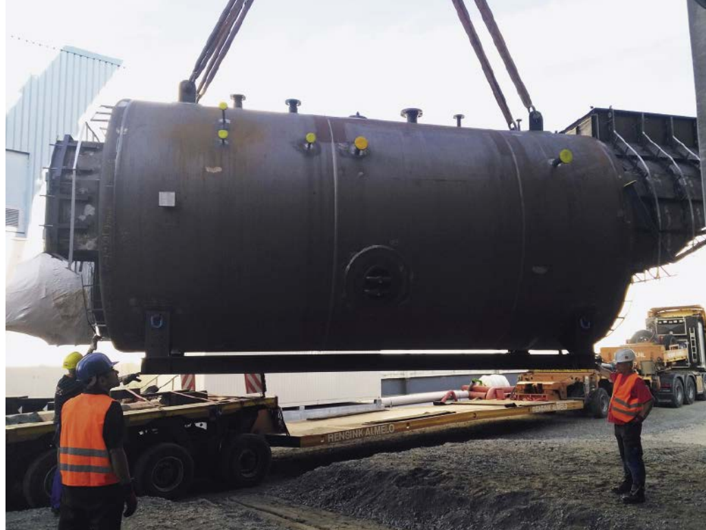
■ Abb. 3: Die beiden Dampfkessel von Viessmann bei der Einbringung am DMK-Standort in Strückhausen.
