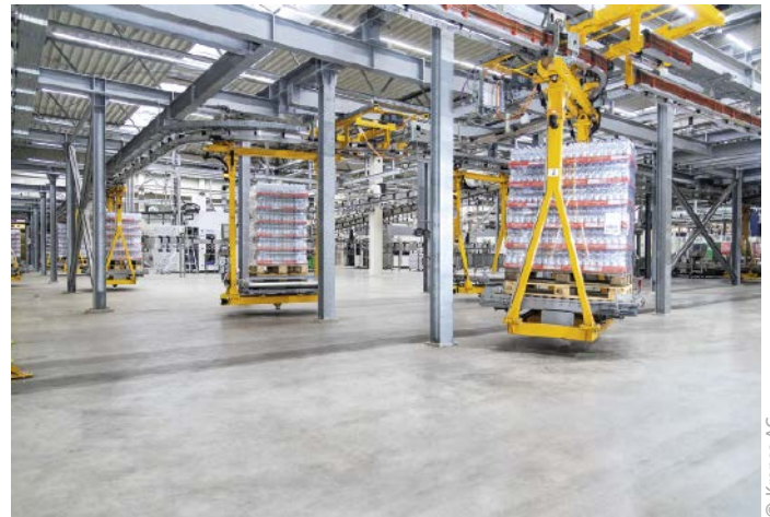
■ Abb. 4: Die Materialflusstechnik wurde angepasst, indem acht neue Elektrohängebahn-Fahrzeuge eingebaut und in die bestehende Struktur eingepasst wurden.
