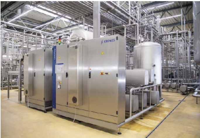
■ Abb. 3: Ein vorhandener Karbonisierer wurde versetzt, um im zentralen Sirupraum Platz zu schaffen für den neuen Mehrkomponenten-Mixer Contiflow.
