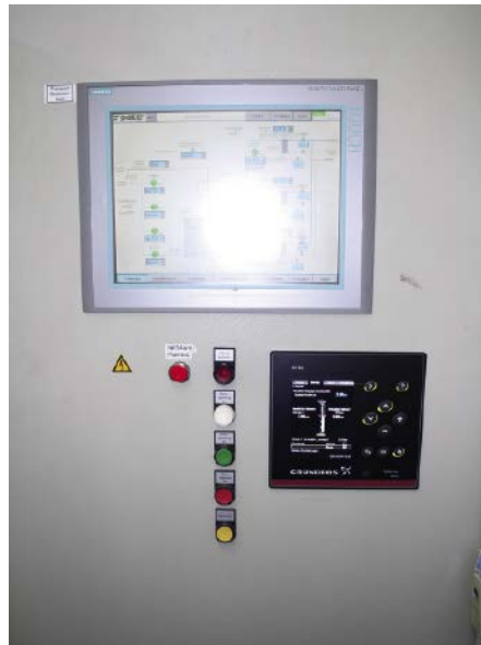
■ Abb. 3: Der Ersatz der alten Steuerung leistet mit intelligenten Algorithmen und hinterlegten Kennlinien einen weiteren Beitrag für noch mehr Effizienz.
