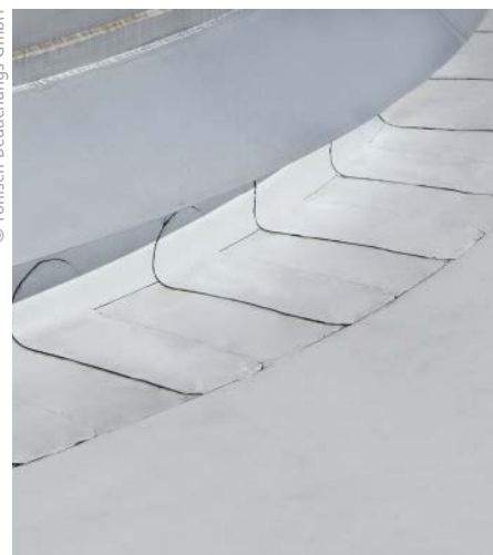
■ Abb. 4: Die dachdurchdringenden Edelstahltanks auf dem Flachdach wurden mit auf der Baustelle angefertigten Sondereinfassungen aus Sarnafil TG 66-18 abgedichtet.
