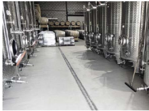
Abb. 2: Im Tanklager sorgen Kombirinnen von Aschl (1A Edelstahl GmbH) für eine effiziente Wasser- und Schmutzabfuhr. Die Entwässerungsabläufe sind tottraumfrei, also ohne Ecken, Kanten und Hohlräume, wo sich Schmutzreste ansammeln könnten.
