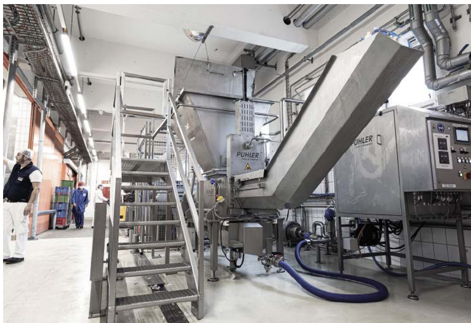
Abb. 1: Weima Puehler G.300 Rework Presse mit Hydraulik und Schaltschrank (rechts).
