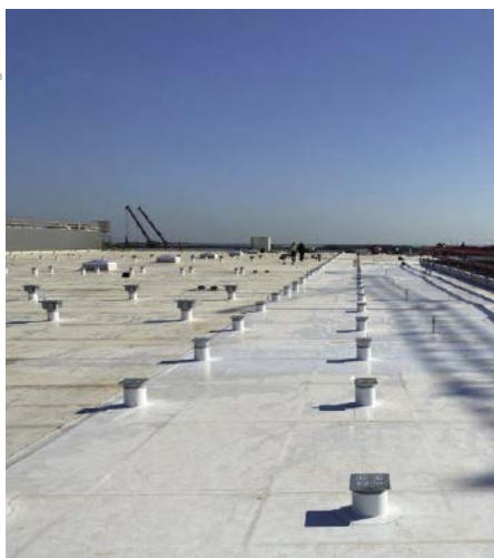
■ Abb. 2: Auf dem Flachdach befindet sich die Lüftungstechnik für das Molkerei-Gebäude, die von einer Unterkonstruktion mit 900 Stützfüßen getragen wird. Die Dachdurchdringungen wurden mit Sondereinfassungen abgedichtet.
