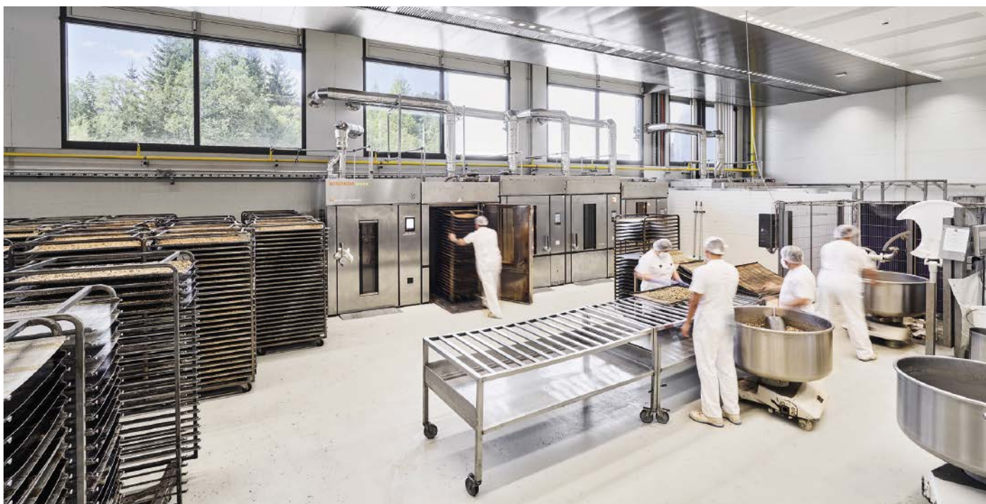
Abb. 1: Produktionsstand Hochfilzen in Tirol: Über den Öfen ist die Hygienedecke von Halton in Edelstahl ausgeführt. Deutlich zu sehen ist die fugenlose, flache Konstruktion der Lüftungsdecke.
