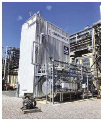
■ Abb. 2: Die Wärmespeichermodule bei Yara in Porsgrunn mit Verkleidung und Boiler.
