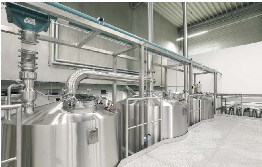
■ Abb. 3: Das Herzstück der neuen Brauerei: ein vollautomatisches Kompakt-Sudhaus Combicube.
