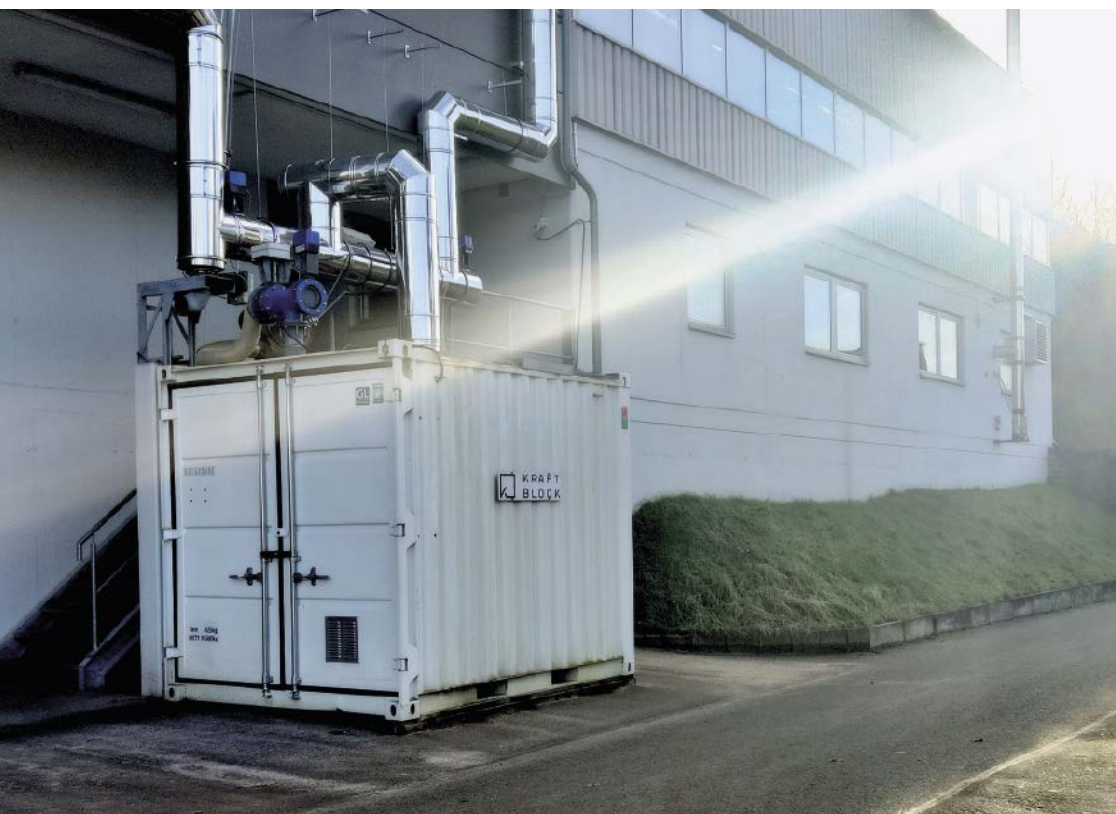
■ Abb. 4: Der Speicher wird in standardisierten Containern von 10, 20 oder 40 Fuß gebaut.
