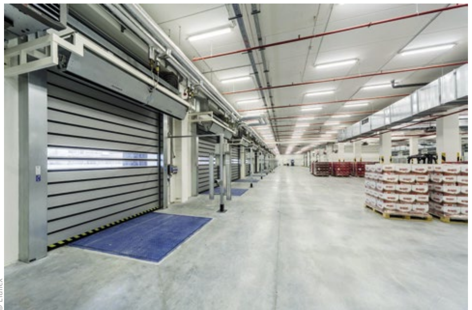
■ Abb. 2: Schnelllauf Tore in der Innenansicht bei Budweiser. In einigen Bereichen des Logistikzentrums absolvieren die Tore über 250.000 Öffnungszyklen pro Jahr.
