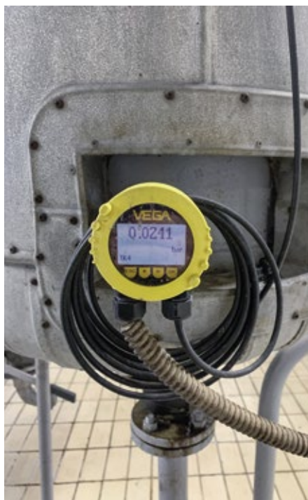
■ Abb. 2: Bonollo ist überzeugt vom Plics-Konzept, dadurch verliefen der Einbau und die Inbetriebnahme ganz unkompliziert.
