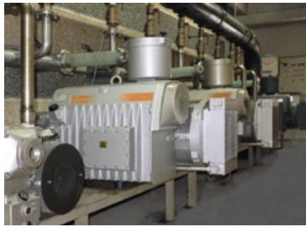
■ Abb. 2: Teilansicht der Vakuumzentralanlage von Busch.
