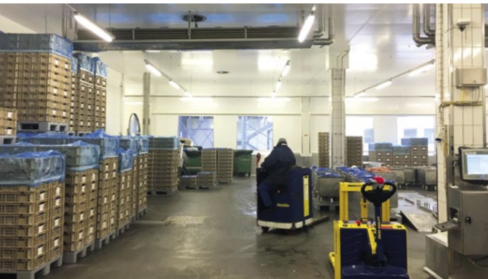
■ Abb. 1: In der Lebensmittelproduktion spielt die Hygiene eine große Rolle. Auch die Lamellen von Verdampfern müssen regelmäßig gereinigt werden, was einen hohen Arbeits- und Materialaufwand bedeutet.
