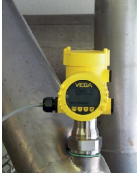
■ Abb. 2: Der Vegapuls 64 misst kontinuierlich den Füllstand im Brennkessel.
