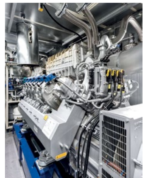
■ Abb. 2: Die Abwärme aus dem BHKW-Motor dient zur kosteneffizienten Dampferzeugung.
