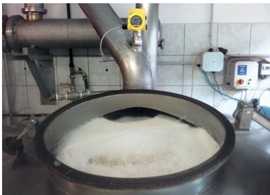
■ Abb. 3: Kleiner Behälter, klebrige Masse und Einbauten im Kessel – der Vegapuls 64 misst dennoch zuverlässig.
