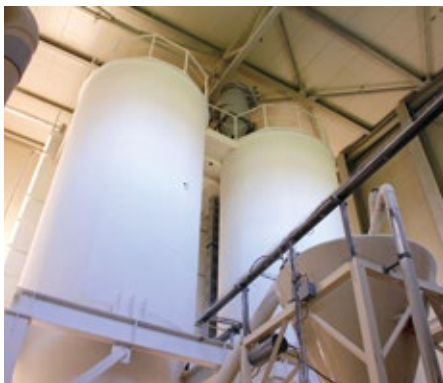
■ Abb. 2: Druckluft hat in mehlerarbeitenden Betrieben unter anderem die Funktion, das Mehl zu befördern: Aus Silos wird das Mehl in ein Förderrohr gepumpt und per Druckluftbeimischung zum nächsten Prozessschritt, bspw. zur Mehlwaage, transportiert.
