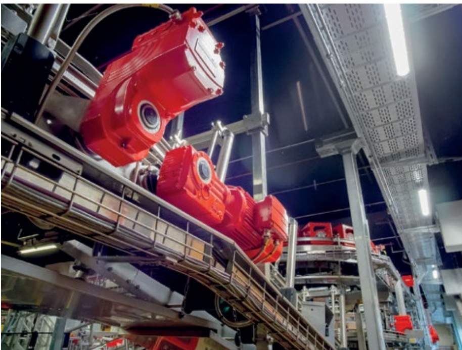
■ Abb. 3: Beim Kastentransport kommt neben den mechatronischen Antriebseinheiten auch Standardantriebstechnik von SEW-Eurodrive zum Einsatz.
