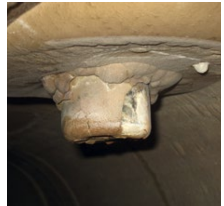
■ Abb. 3: Innenansicht eines Rohres mit Kalkablagerungen sowie der Ceramat WA 150 von unten.
