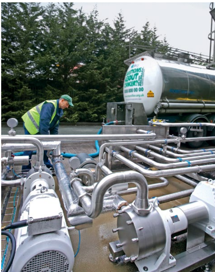
■ Abb. 2: Durch den Einsatz von Sinuspumpen konnten bei Halewood International Probleme mit Kavitation gelöst werden.
