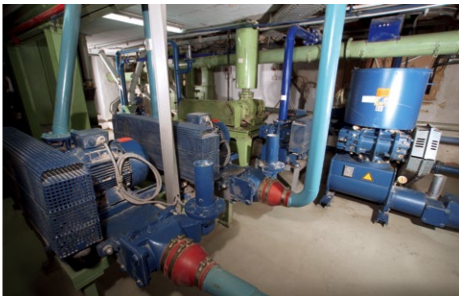
■ Abb. 2: Sieben nicht schallgedämpfte Aerzener Drehkolbengebläse arbeiten in der zentralen Station der Milser Mühle in Bielefeld. Sie ist seit über 130 Jahren im Besitz der Familie Borgstedt.
