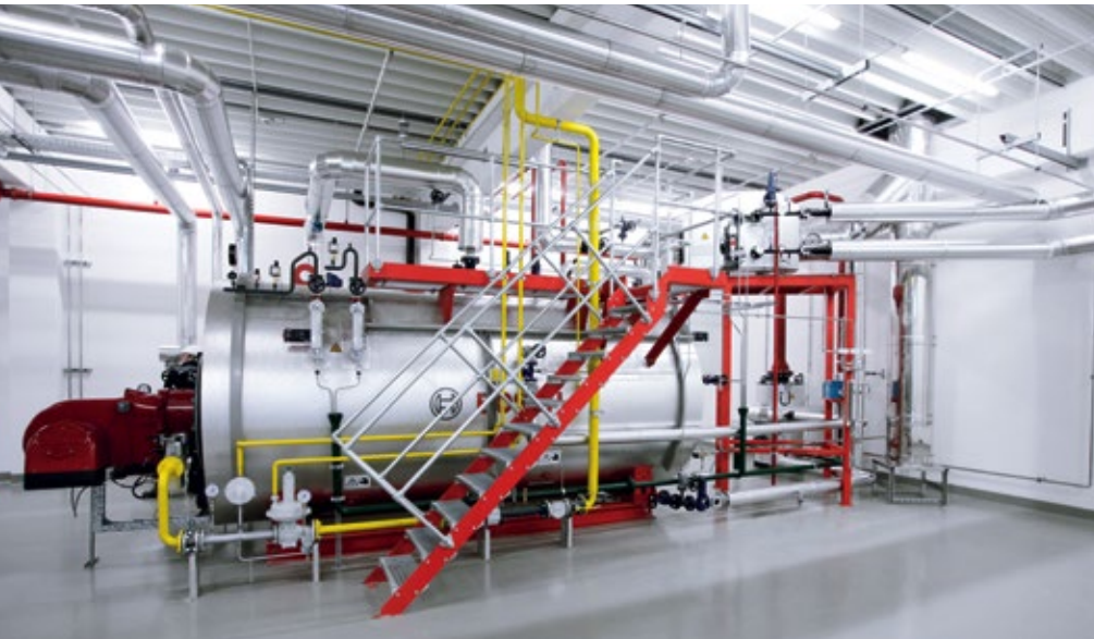
■ Abb. 1: Der neue, hocheffiziente Dampfkessel UL-S mit Erdgasfeuerung und Einrichtungen zur Wärmerückgewinnung
