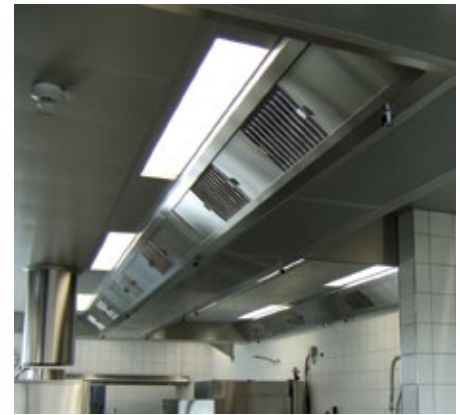
■ Abb. 2: Multifunktionale Edelstahl-Lüftungsdecke in einer Fleischwarenfabrik.
