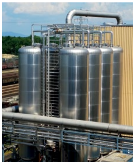
■ Abb. 2: Das mit Cadison geplante neue Rohfett-Tanklager wurde mittlerweile erbaut und in Betrieb genommen.
