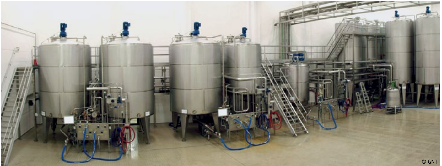
■ Abb. 2: In der rund 2.500 m 2 großen GNT-Anlage sorgen neueste Technologien für gesteigerte Effizienz und ökologische Vorteile. Die Anlage arbeitet weitgehend automatisiert und erhöht die Chargengröße Färbender Lebensmittel auf bis zu 25.000 kg.
