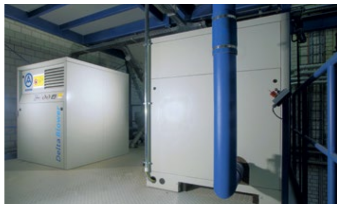
■ Abb. 2: Die Förderluft-Station im neuen Technikum besteht aus zwei Aerzener Drehkolbengebläsen der Baureihe Delta Blower und einem Drehkolbenverdichter der Baureihe Delta Hybrid.
