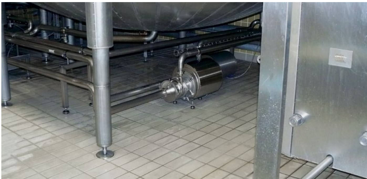
■ Abb. 2: Die bei Erdinger Weißbräu installierte GHP-Pumpe im CIP-Rücklauf.
