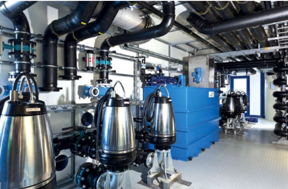
■ Abb.: Teilansicht einer Envimodul-Abwasserbehandlungsanlage.
