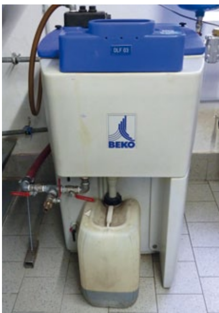
■ Abb. 3: Der 2008 installierte Öwamat 15 bei Brandt bereitet zuverlässig das Kondensat auf. Ein jährlicher Filterwechsel genügt.
