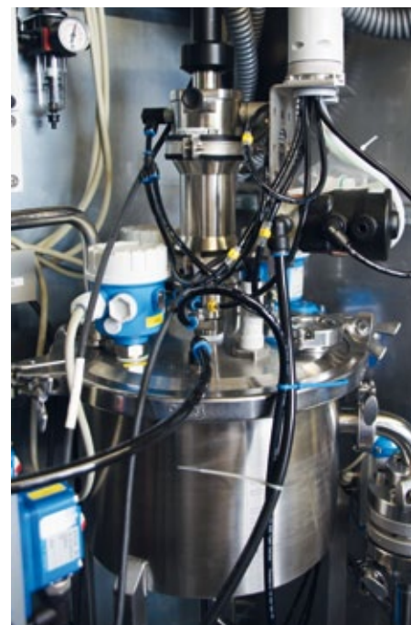
■ Abb. 3: Hightech auf engstem Raum: Leitfähigkeitssonde Indumax CLS50D, pH-Elektrode Orbisint CPS11 mit automatischer Reinigungsarmatur Cleanfit CPA472 und Füllstandsgrenzschalter Liquiphant FTL50 am Probenahmebehälter. © Endress + Hauser
