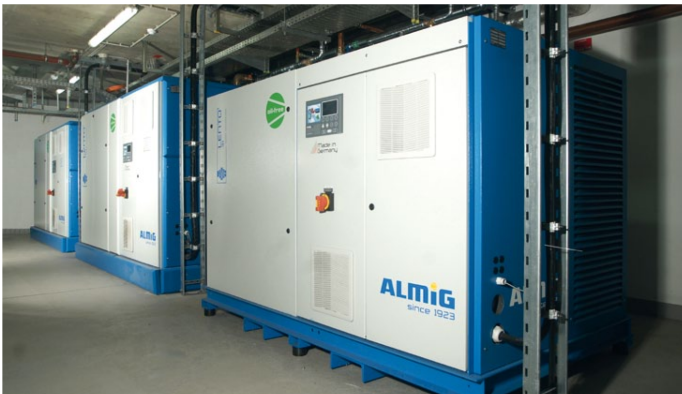
■ Abb. 2: Das Bild der Druckluft-Station zeigt im Vordergrund die 31-kW-Anlage, dahinter die zwei 110-kW-Anlagen.
