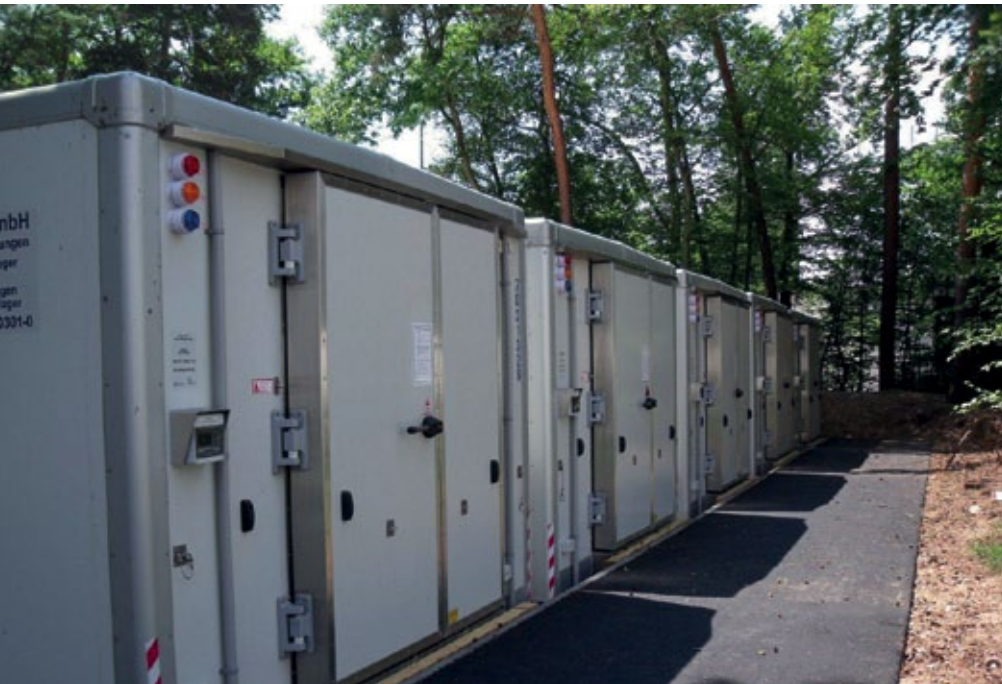
Abb. 1: Aufstellung von Super Boxen im Außenbereich.
