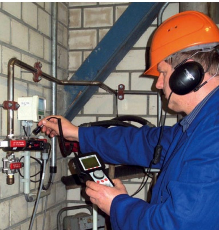
■ Abb. 1: Das Sonaphone spürte in Könnern auch Undichtheiten an bisher unauffälligen Ventilen auf.
