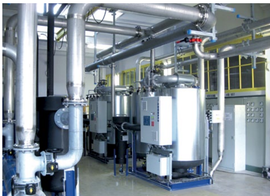
■ Abb. 1: Die Druckluftaufbereitung mit den beiden Everdry-Adsorptionstrocknern steht in einem Raum, der zuvor eine Dampfturbine beheimatet hatte.
