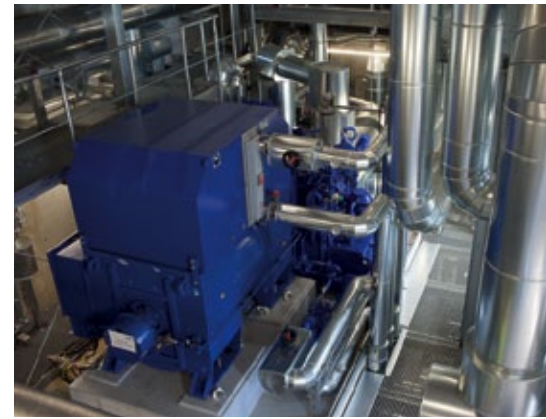
■ Abb. 2: Die Dampfturbine
