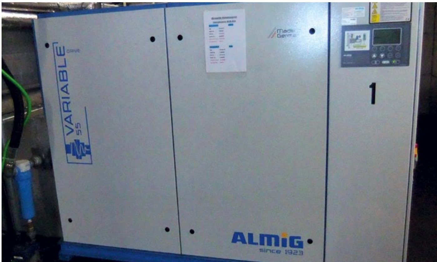
Abb. 3: Zum Einsatz kommen jetzt zwei Schraubenkompressoren der Baureihe Variable 55. Diese arbeiten im mittleren Drehzahlbereich. Damit sind sowohl der Energiebedarf als auch die Geräuschemission geringer. Ebenso werden die Bauteile weniger belastet, was sich auf die Lebensdauer der Kompressoren auswirkt. Die integrierte Almig Control 3-Steuerung managt alle Kompressoren verbrauchsabhängig im Verbund. © Bilder: Almig Kompressoren
