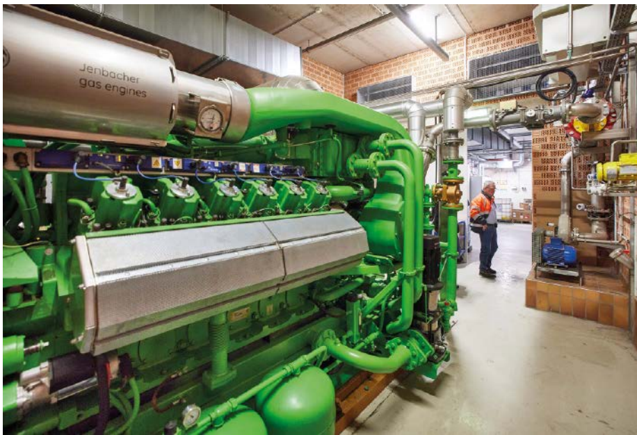
■ Abb. 5: Die Verstromung des Gases erfolgt in mehreren Gas-Otto-Motoren mit einer Gesamtleistung von bis zu 4 MW.
