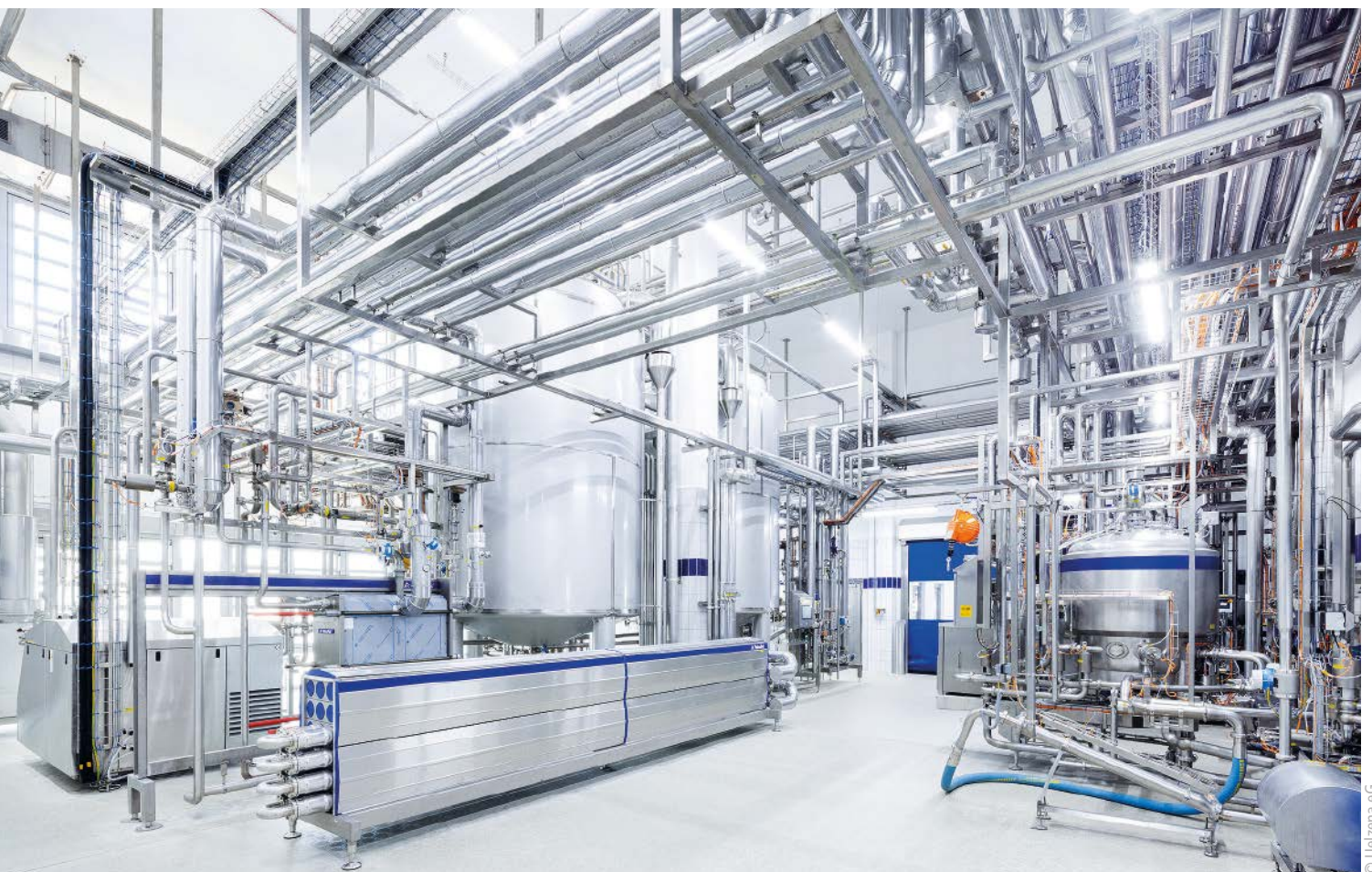
Abb. 1: Zu „Turm 12“ gehören neben dem eigentlichen Sprühturm weitere zentrale Bereiche, wie ein leistungsfähiger Nassmischbereich mit verschiedenen Technologien zur Vorbereitung der Rohstoffe.
