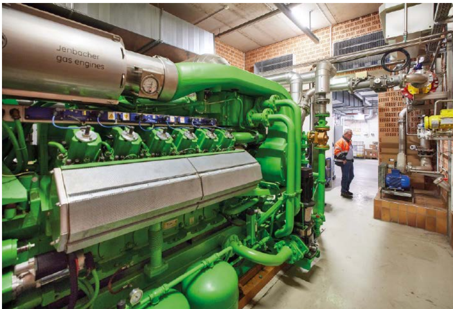
■ Abb. 5: Die Verstromung des Gases erfolgt in mehreren Gas-Otto-Motoren mit einer Gesamtleistung von bis zu 4 MW.
