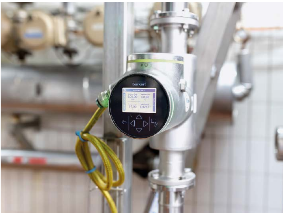
■ Abb. 5: Durchflussmesser vor dem Eindampfer. Die Durchflussmenge liegt bei 20.000 l/h.
