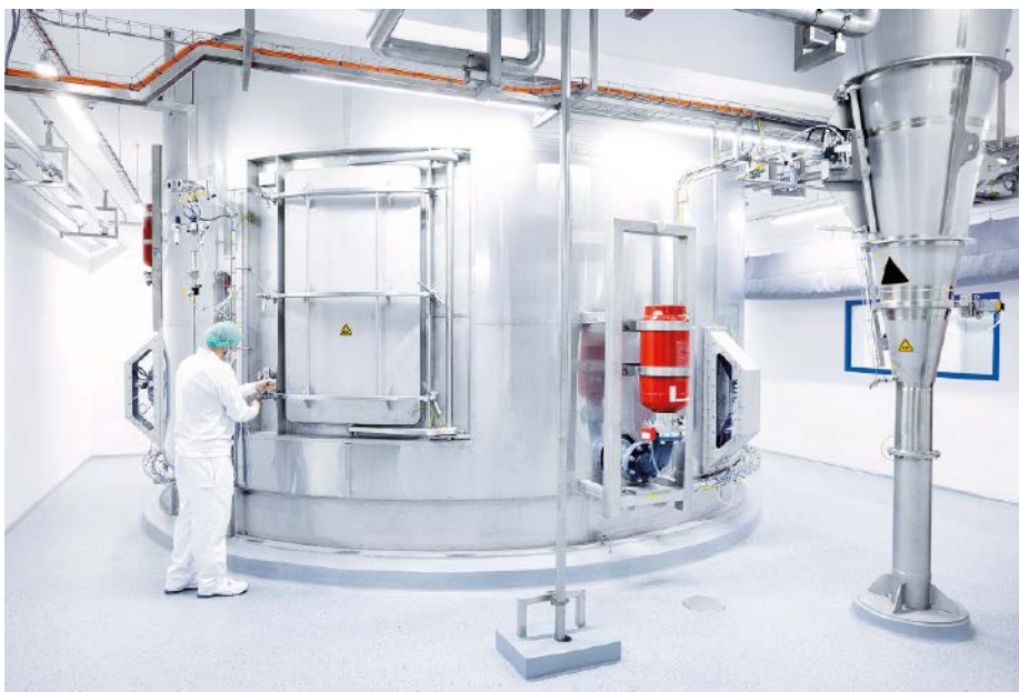
■ Abb. 2: Das neue Werk verfügt über einen 15 m hohen Sprühlturm mit einem flexiblen Düsen-Sprühsystem und einer Leistung von 650 – 750 kg Pulver pro Stunde.
