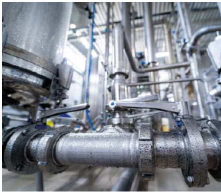
■ Abb. 2: Kondenswasser an einer Rohrleitung in einer Brauerei.
